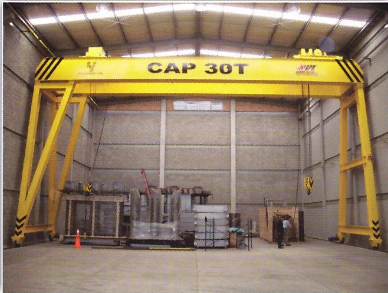
FYR Ingenieros Ltda. - Bogotá Grúa Pórtico - Birriel - 30.000Kg
