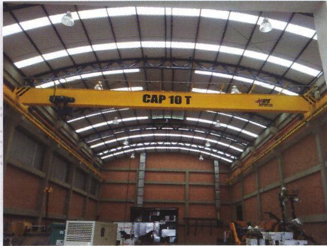
Rent-Industrial - Centro Industrial Celta Puente Grúa Monorriel - 10.000Kg
