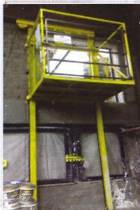
Home Center Calle 80 - Bogotá Ascensor de Carga - 1000Kg
